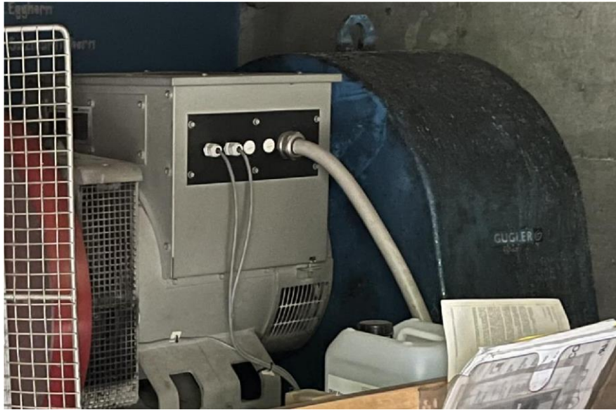
Bild: Wasser-Turbine und Generator des 'getarnten' Kraftwerks.
